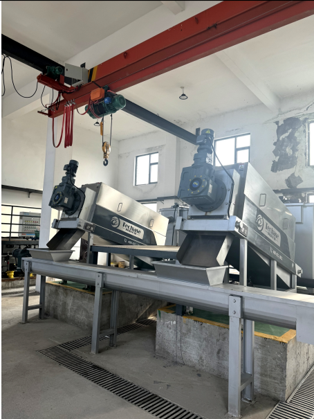
沁水县第三自来水厂叠螺脱水机
