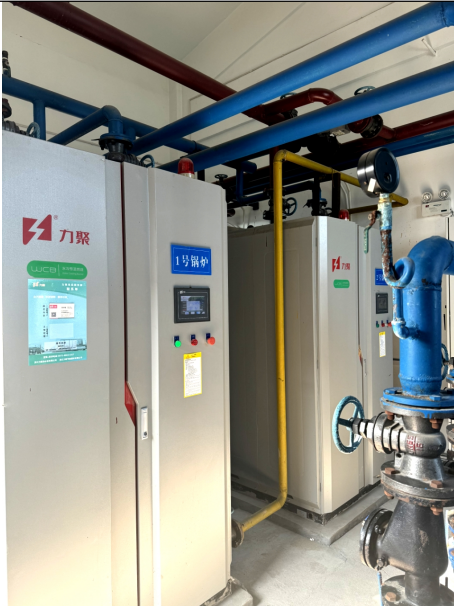
沁水县第三自来水厂燃气锅炉（一用一备）
