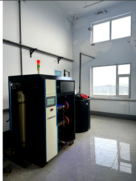
沁水县第三自来水厂次氯酸钠发生器
