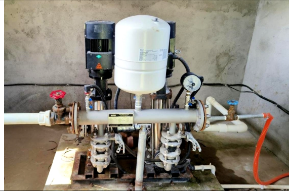
小区二次供水设备现状
