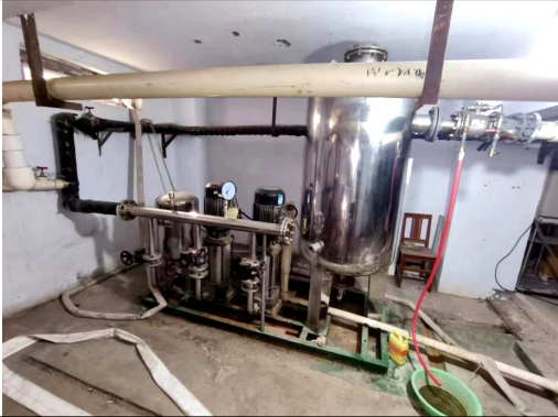
小区二次供水设备现状
